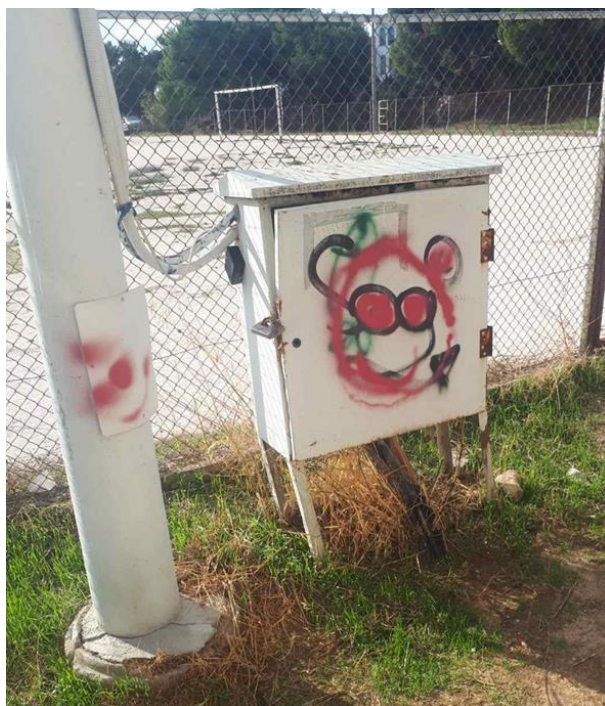
ΕΙΚΟΝΑ 19:Φωτογραφία της υπάρχουσας ηλεκτρολογικής εγκατάστασης του γηπέδου ποδοσφαίρου
